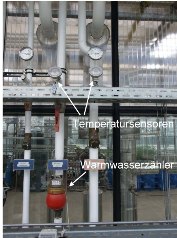
Abbildung 3: Technik für die Wärmeverbrauchsmessungen in den Gewächshausabteilen
