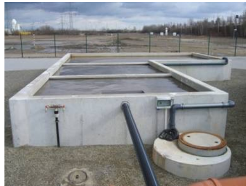
Abbildung 9: Dreistufiges Absetzbecken zur Aufbereitung des Reinigungswassers des Siebtrommelfilters
