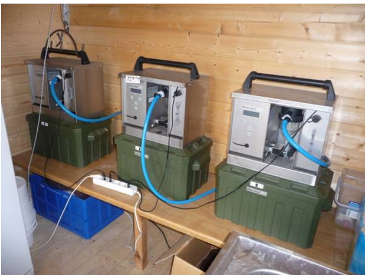
Abbildung 11: Probenahmeautomaten in der wetterabweisenden frostsicheren Umhausung
