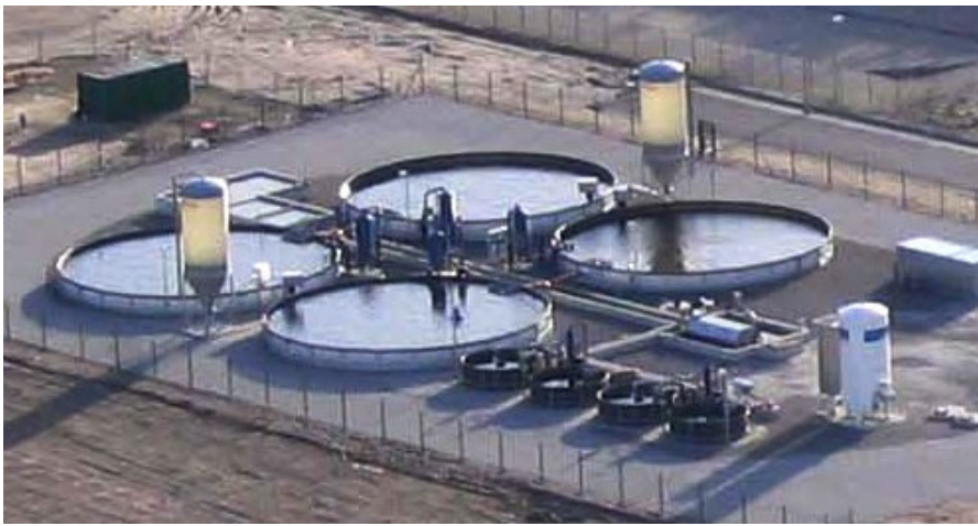
Abbildung 2: Blick auf die Anlage Schwarze Pumpe (Foto Sieg)
