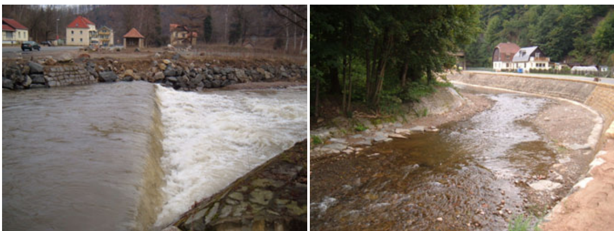
Abbildung 20: Wehranlage Weesenstein vor Rückbau (links); Sohlgleite mit eingebauten Sohlriegel und Niedrigwasserrinne nach Rückbau (rechts)
