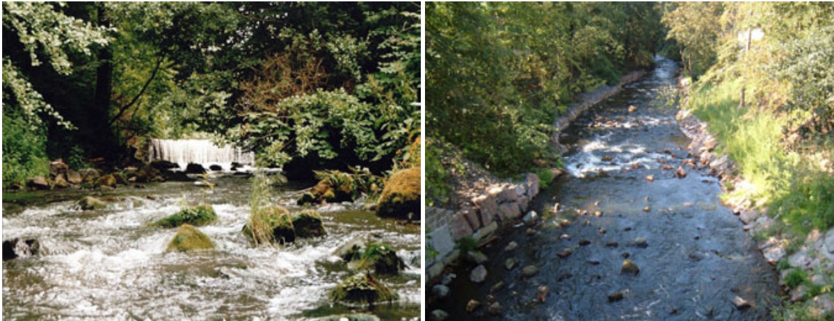
Abbildung 21: Absturzbauwerk Pirna-Liebenthal vor Rückbau (links); Gesamtansicht der Riegelrampe vom Oberstrom nach Rückbau des Absturzes (rechts)
