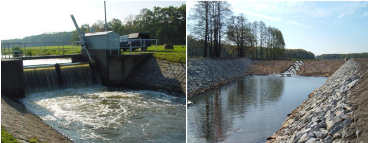
Abbildung 24: Ehemaliges Klappenwehr Steinitz/Kolbitz vor Rückbau (links); Schüttsteinrampe mit Fischgasse nach Rückbau der Wehranlage (rechts)
