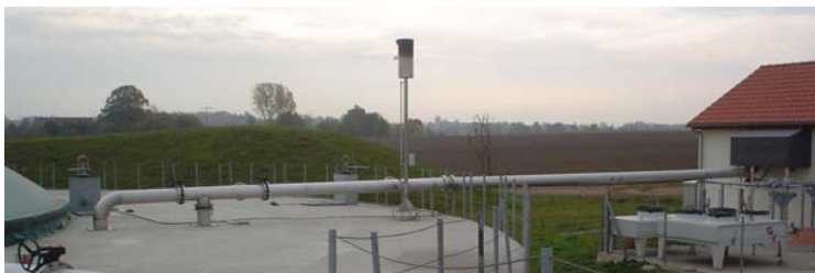
Abbildung 33: Biogasrohrleitung vom Fermenter in den BHKW-Raum der Biogasanlage bei der Tobias Barthel und Christian Landwehr GbR Geithain, OT Wickershain (Kreis Leipzig)
