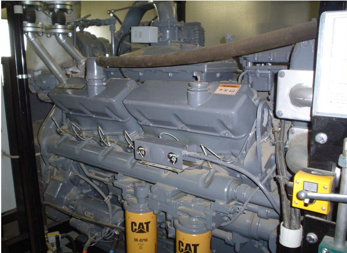
Abbildung 47: Biogas-BHKW „Caterpillar G 3412 TA“ der Agrargenossenschaft e. G. Hainichen-Pappendorf
