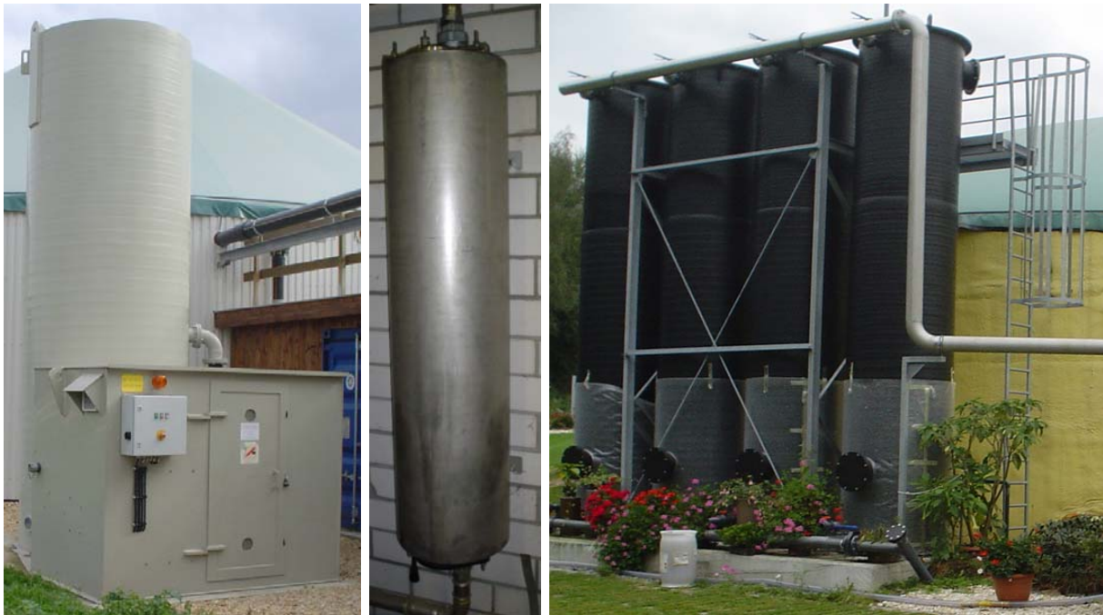
Abbildung 30: Beispiele externer Entschwefelungsanlagen ( links → Tropfkörper-/Biorieselbettreaktor der LAWI Agrar GmbH Hirschfeld (Landkreis Zwickau), Mitte → Aktivkohlefilter beim Landwirtschaftsbetrieb Philipp GbR Großweitzschen, OT Strölla (Landkreis Mittelsachsen), rechts → Gaswäscher bei Biogas und Landtechnik Trieb (Vogtlandkreis, Sachsen))
