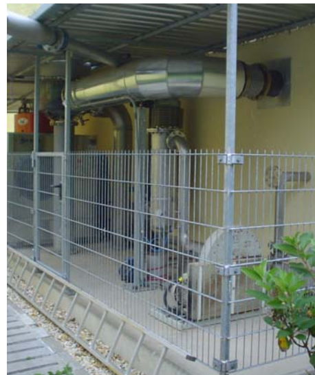
Abbildung 34: Gaskühler an der Biogasanlage beim Agrarbetrieb Landtechnik u. Biogas Trieb (Vogtlandkreis, Sachsen)
