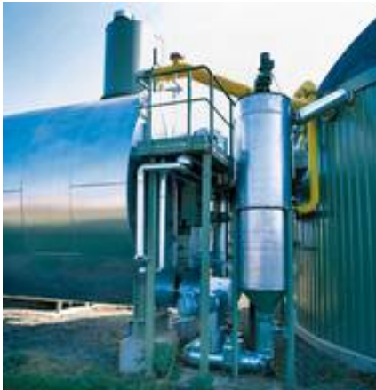
Abbildung 23: Hygienisierungseinrichtung „ARCHEA ThermDes®-Anlage“ der Firma ARCHEA Biogastechnologie GmbH Hessisch Oldendorf /26/
