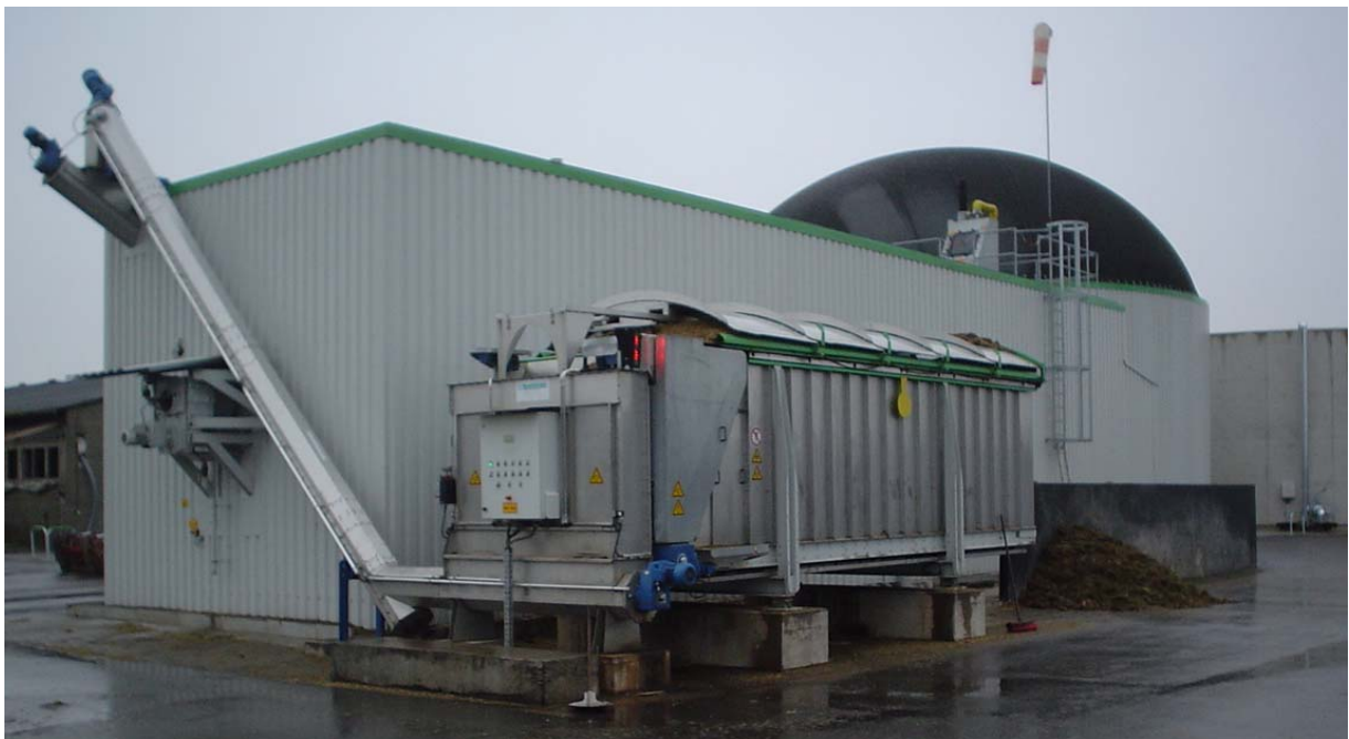
Abbildung 9: Pfropfenstrom- u. Rührkesselfermenter sowie Gärrestlager an der Biogasanlage der Agrargenossenschaft Krippelna e. G. Zschepplin (Landkreis Nordsachsen)
