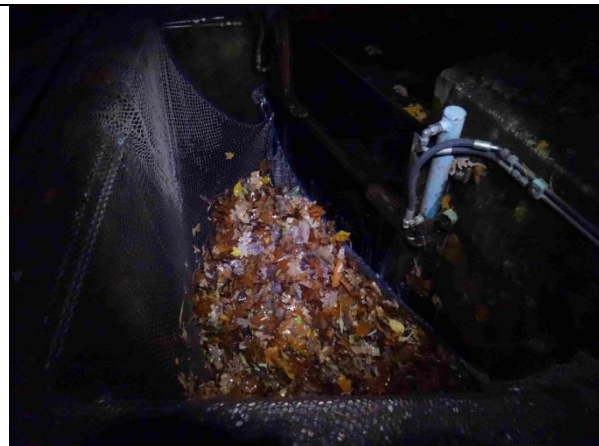
Rechengut im Auffangnetz
