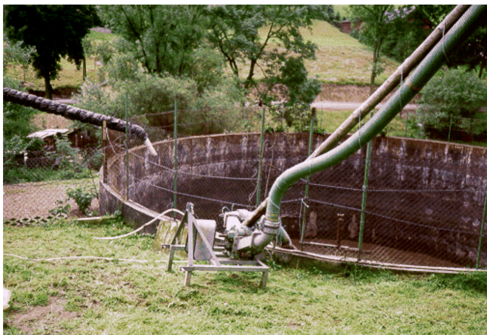
Abbildung 1.6 Erdbecken zur Lagerung des vergorenen Substrates
