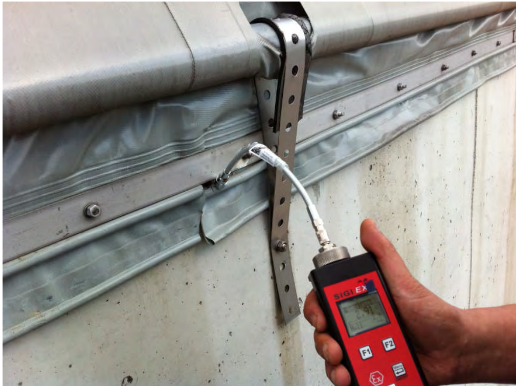
Abb. A.4.4: Detailaufnahme einer Gasaustrittsstelle
