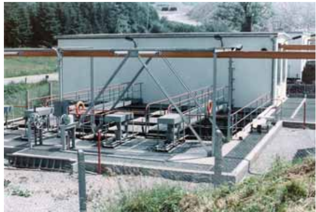
Abb. 9-3: Die 1988 errichtete Wasserreinigungsanlage
