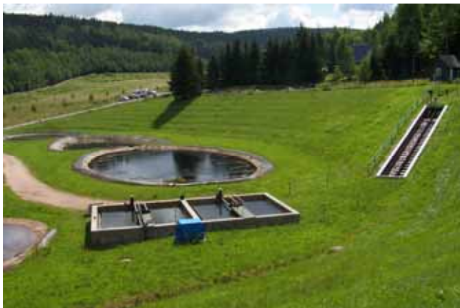
Abb. 9-6: Passiv-biologische Anlage mit Zulaufkaskade, Absetzbecken und bepflanzten Becken
