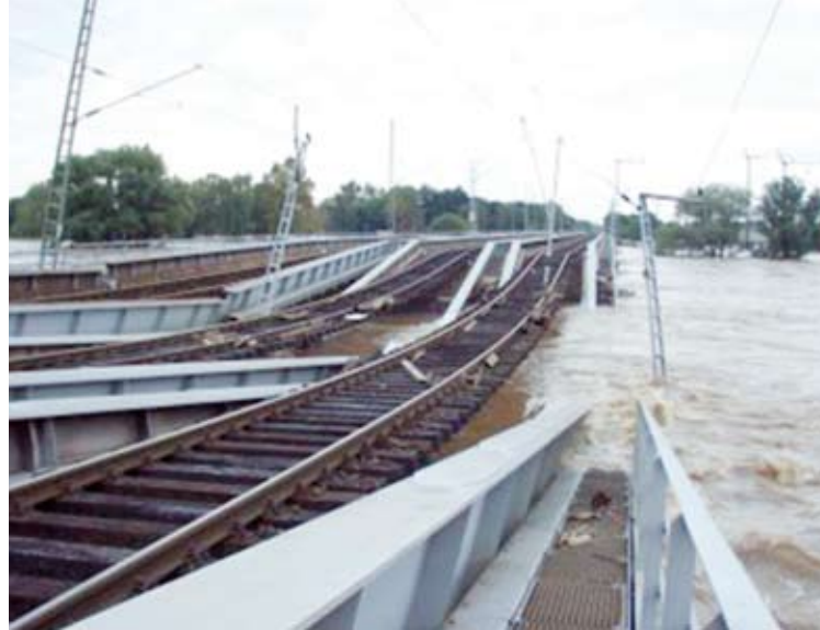
Zerstörte Eisenbahnbrücke in Eilenburg 2
