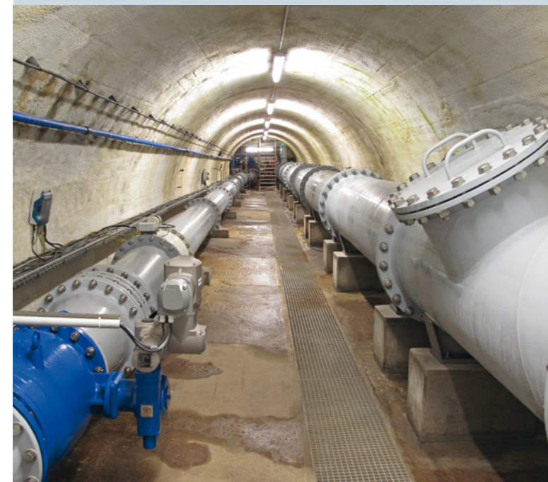
Entnahmeleitungen im Grundablassstollen
