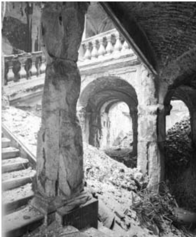
27 Englische Treppe (20. Februar 1952), der herabgestürzte Dachbereich hat das Treppenhaus extrem geschädigt
