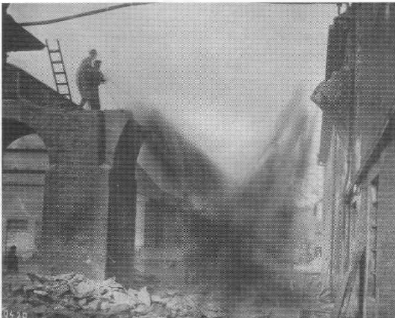
Abriss des Wasserdruckwerkes am Amalgamierwerk der Hütte Halsbrücke BergAFG, BHK – FS S 1566
