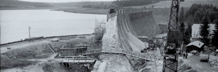
Bruchstelle der Staumauer im Juli 1949
