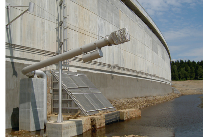
Anlage zur Rohwasserentnahme, nur sichtbar bei entleerter Talsperre
