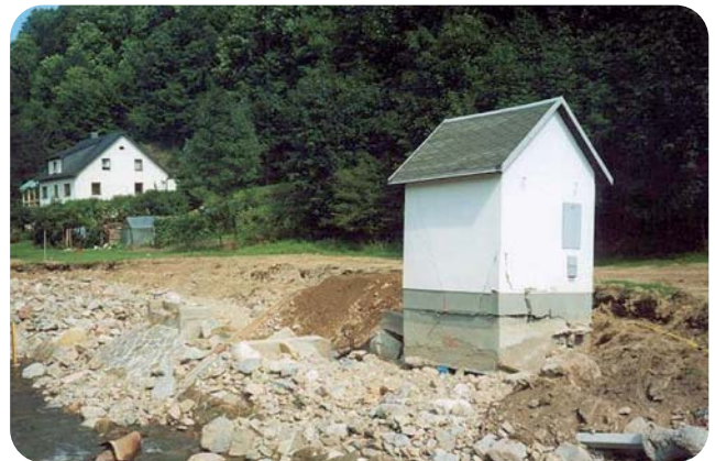
Abb. 30: Zerstörungen am Pegel Liebstadt 1/ Seidewitz
