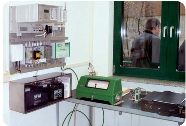
Abb. 33: Neue Ausrüstung im Pegel Aue 1/ Schwarzwasser
