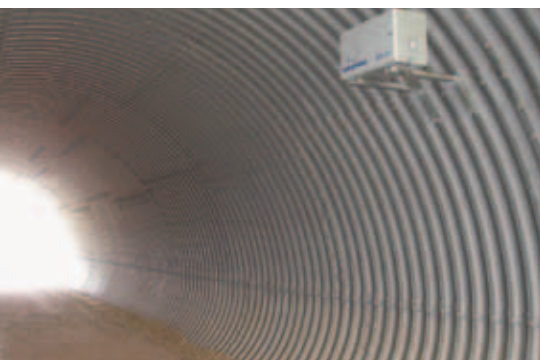
Foto 68: In einem Wellstahlrohrdurchlass wurde eine akustische Permanentüberwachung installiert, um ganzjährig die Fledermausaktivität und somit die Wirksamkeit der Querungshilfe zu überprüfen.
