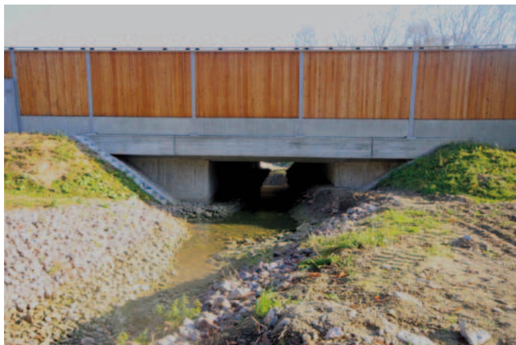
Foto 38: Unterführung eines Baches (A 5 bei Offenburg) mit Irritationsschutzwand. Der Durchlass wurde anstatt eines Rohrdurchlasses (DIN 1000) angelegt und weist eine breite von 5 m und eine Höhe von ca. 2 m über dem Wasserspiegel auf. Er wurde für die Arten Braunes Langohr, Fransenfledermaus und Wasserfledermaus geplant, deren Querungsbeziehungen über eine nun 6 spurige Autobahn nach dem Ausbau verbessert werden sollen. Ein Monitoring beginnt hier erst 2012. Im Bild fehlt noch die geplante Leitstruktur mit beiderseits des Grabens verlaufenden Gehölzreihen.
