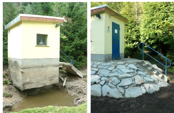
Abb. 1: Pegel Porschdorf 1 Abb. 2: Pegel Porschdorf 1 vor und nach der Schadensbeseitigung in Folge des Auguthochwassers 2010
