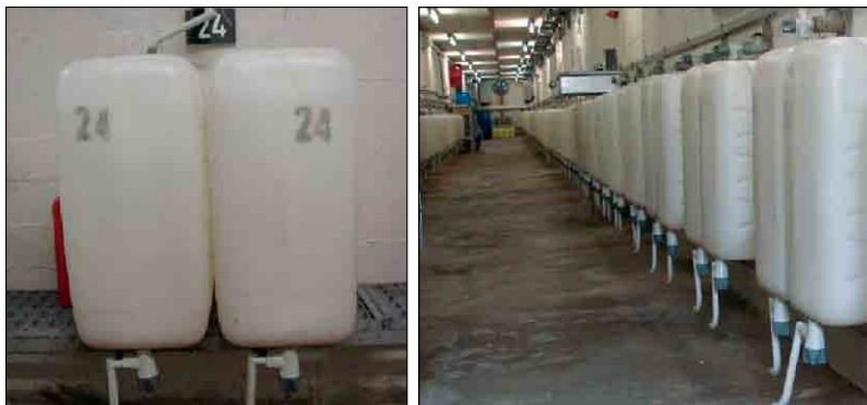
Abbildung 3: Begehbare unterirdische Sickerwasserauffangananlage der Lysimeterstation in Falkenberg (Altmark)
