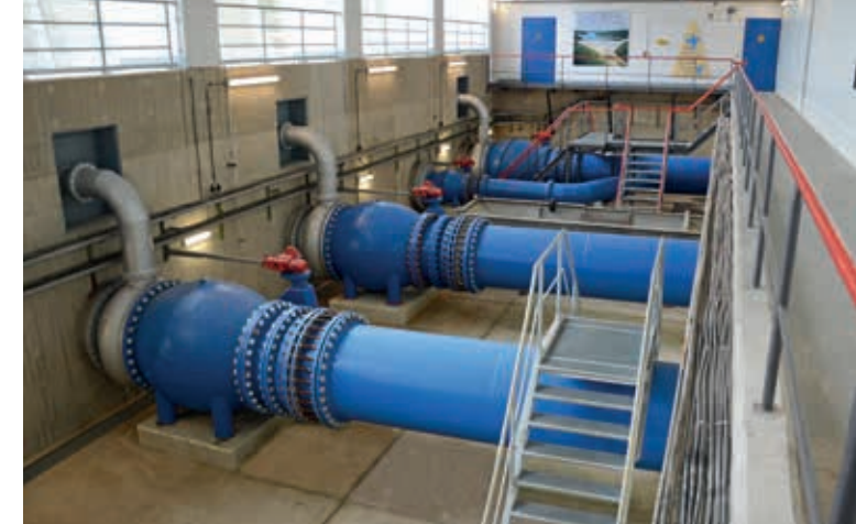
Grundablässe und Ringkolbenventile im Schieberhaus
