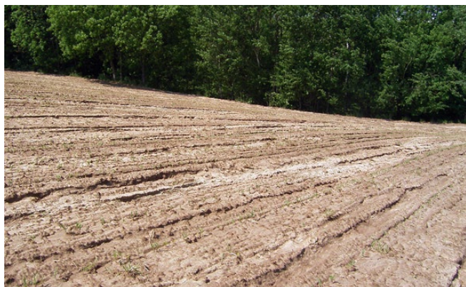
Zahlreiche Erosionsrillen < 10 cm tief
