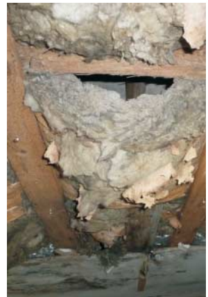
Ruine mit Dämmmaterialien aus „alter“ Mineralwolle im Dachraum
