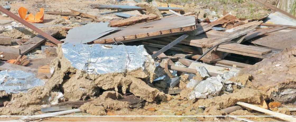
Unsachgemäßer Abbruch eines Gebäudes ohne vorangehenden Ausbau von Mineralwolle
