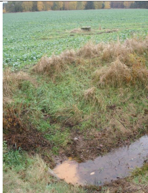
Unterlassene Grabenunterhaltung führt zur Aufhöhung der Grabensohle und Verlandung der Dränausmündung (Bereich Großer Teich, Torgau)
