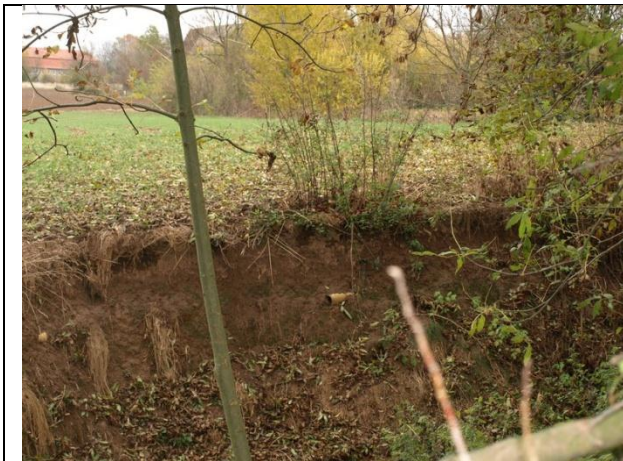
Böschungsrutschung mit freigelegter Drainage im Bereich Jahna
