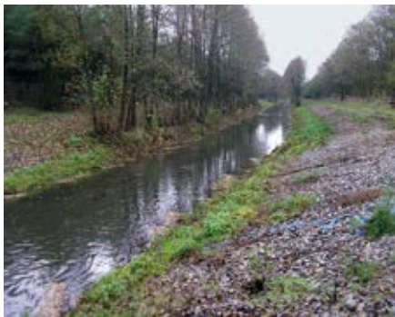
Abbildung 10: Kleine Spree im Unterlauf bei Burg – verlegt, stark eingetieft, Profil stark vergrößert, Sohle mit Folie gedichtet, Sohle und Böschung geschottert
