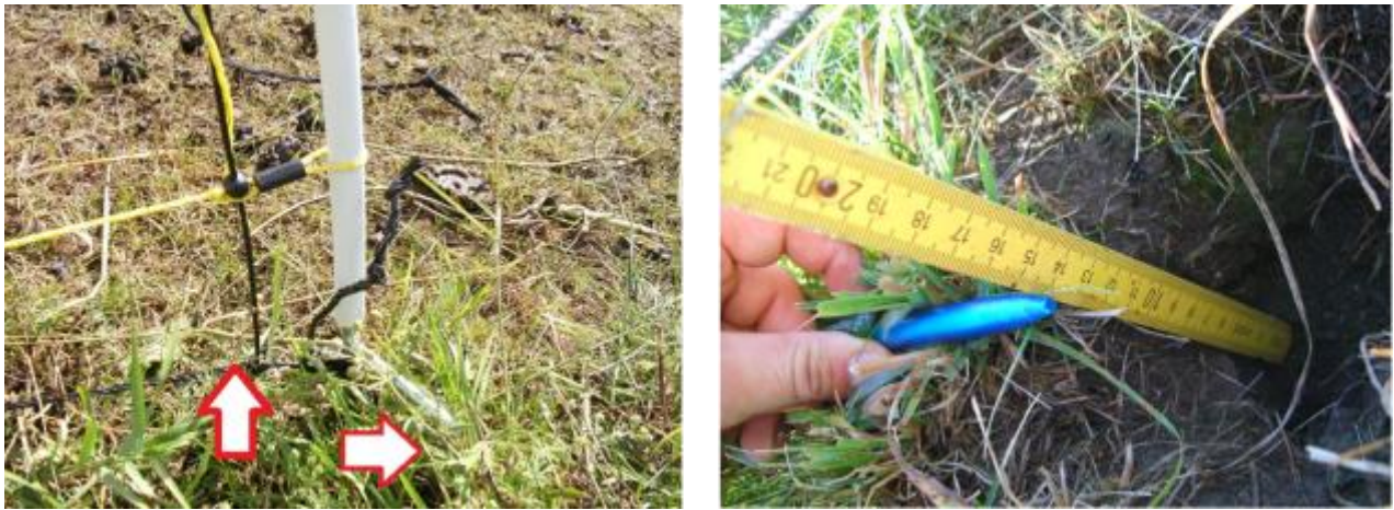
Abbildung 33: Zäune müssen immer bündig am Boden abschließen
