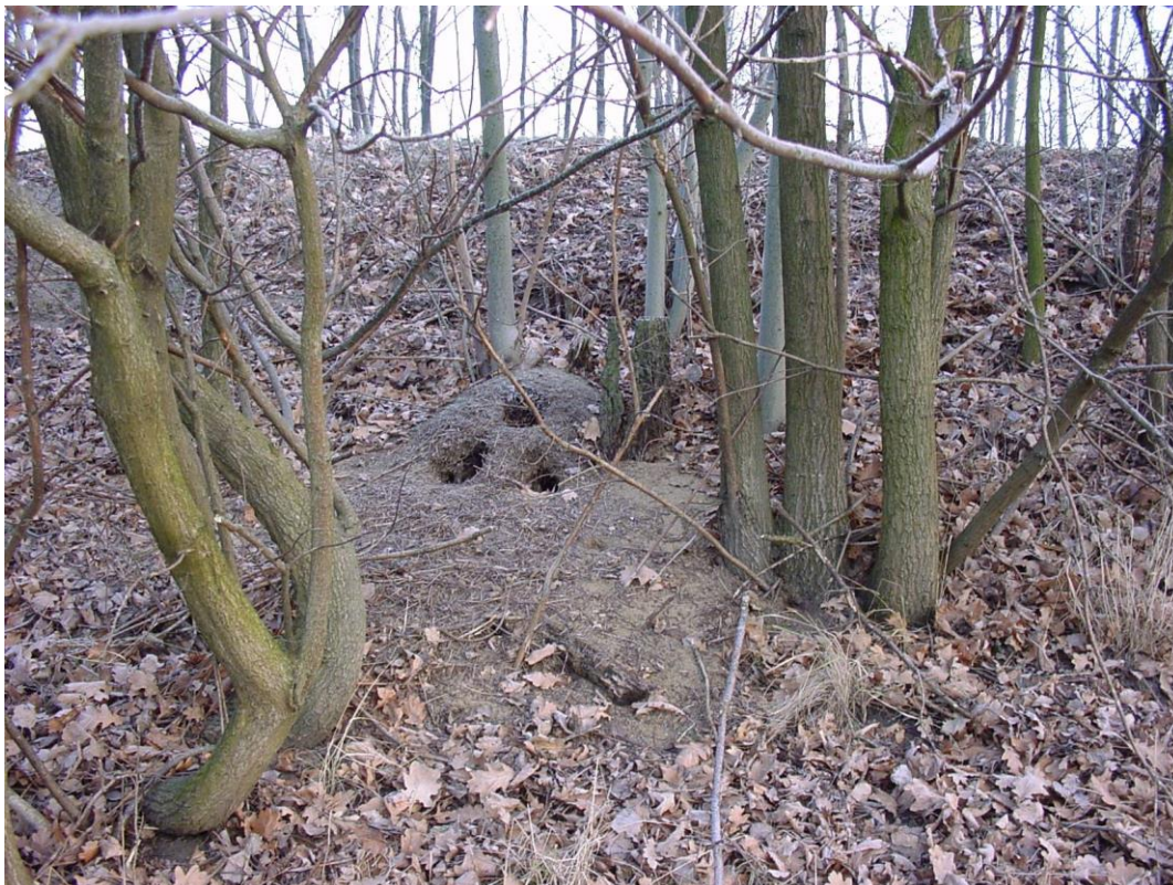
Abbildung 14: Deich mit Wühltierschäden bei Tätzschwitz (Foto: LTV Sachsen)
