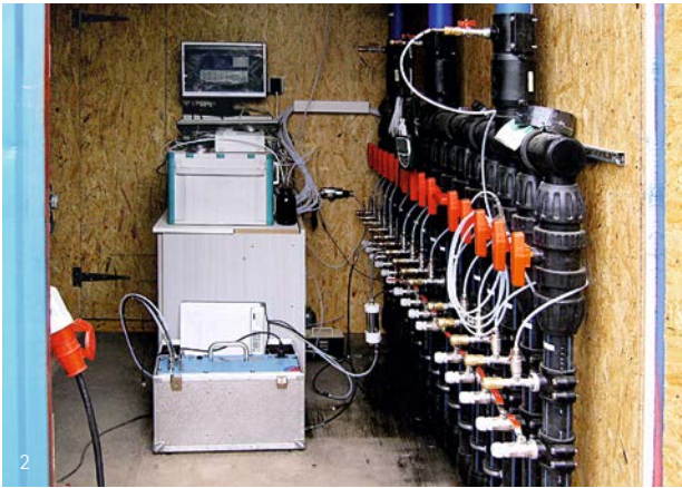
2) Apparatur der Bodenluftabsauganlage einschließlich gaschromatografischer Auswertung
