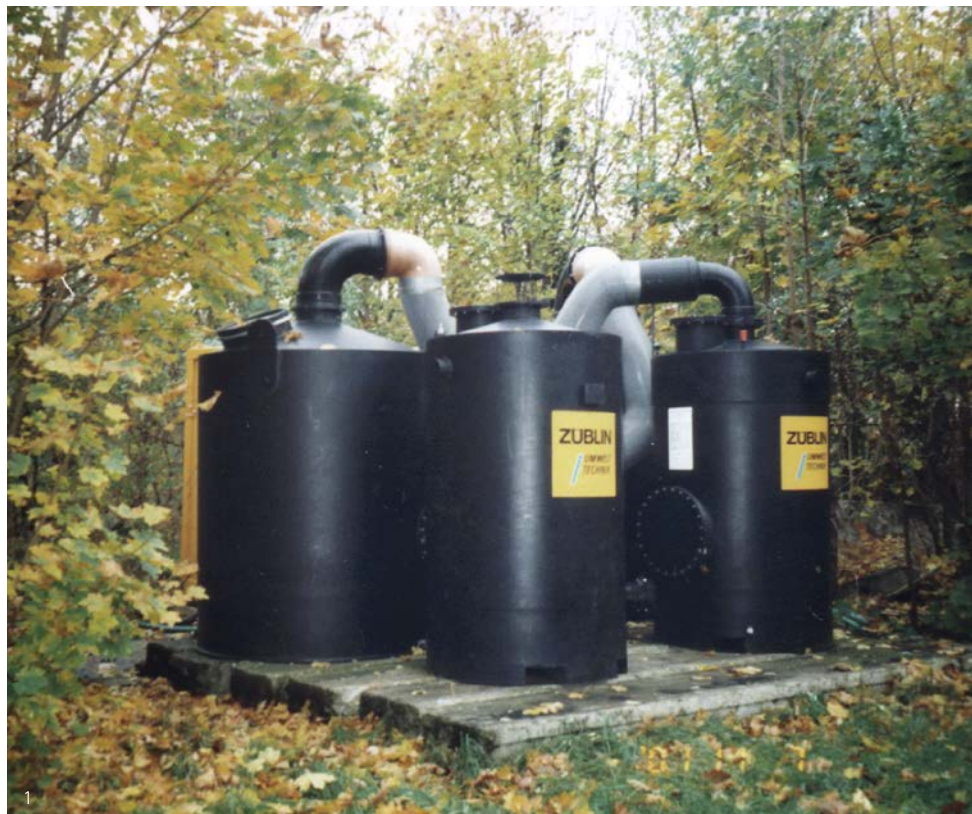
1) Grundwasserreinigungsanlage als zweistufige Stripanlage mit nachgeschaltetem Luftaktivkohlefilter
