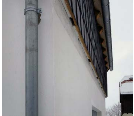
Einschlupf von unten hinter eine Schieferverkleidung Foto: Thomas Frank
