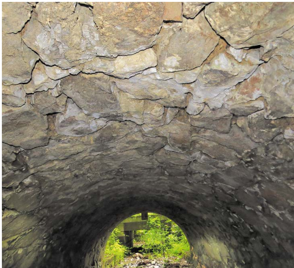
Wasserdurchlass | Foto: Toni Bellstedt
