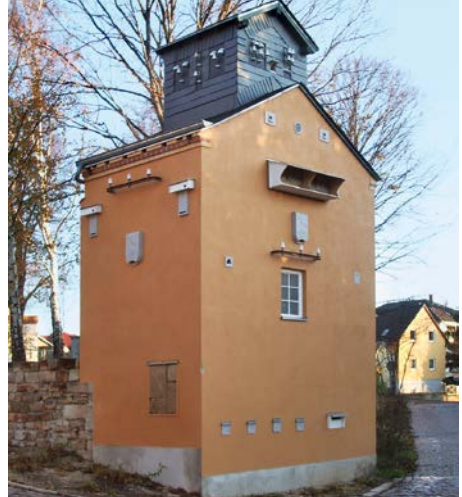
Umgestaltetes Trafohaus in Pesterwitz bei Dresden mit einer Kombination aus Fledermausquartieren und Nisthilfen für Vögel | Foto: Thomas Frank
