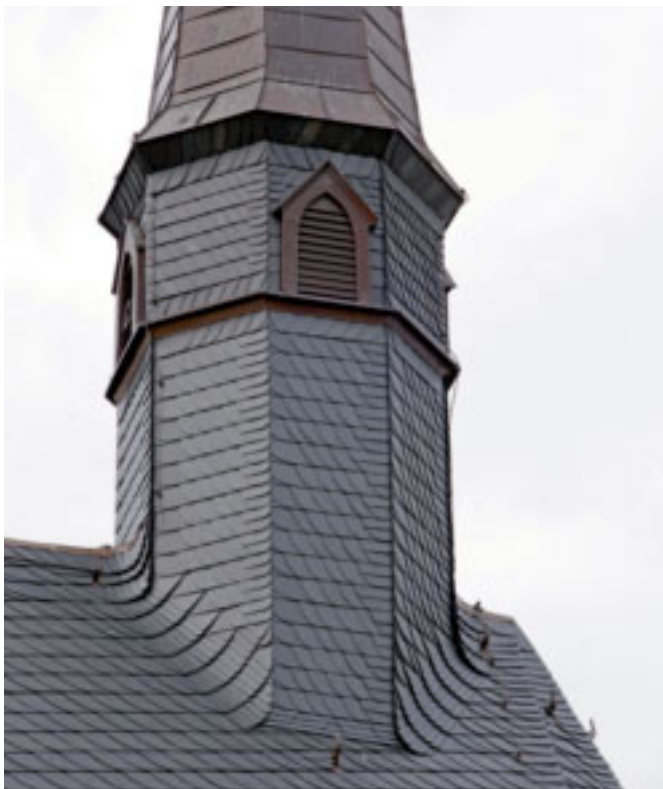
Dachreiter mit Naturschieferverkleidung
