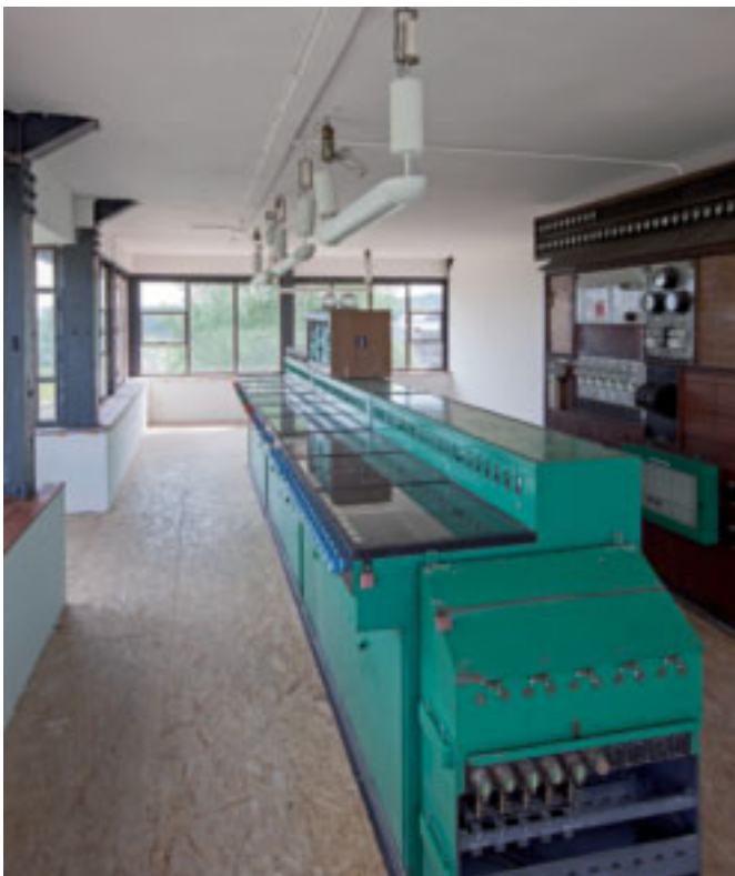
Stellwerk 2 mit elektromechanischer Stellwerkstechnik
