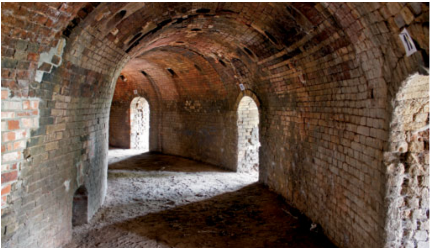
Blick in die ringförmige Brennkammer
