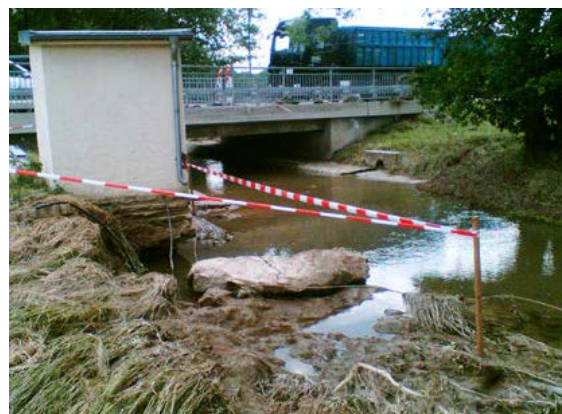
Abb. 3: Hochwasserschäden am Pegel Kotitz / Kotitzer Wasser
