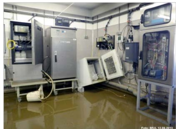
Abb. 6: Laborraum der Messstation Zehren nach dem Hochwasser
