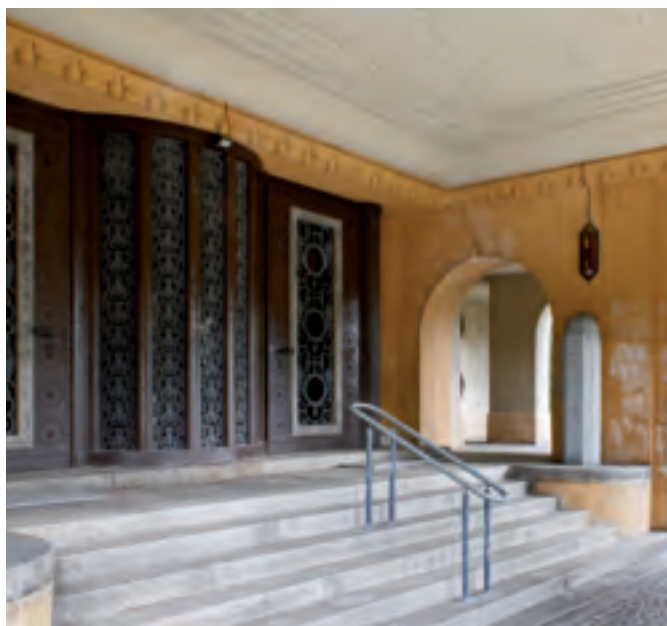
Stav portálu v přední straně věže
