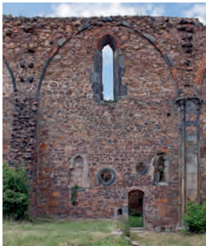
Pohled na strženou hranu bývalého klenutí
