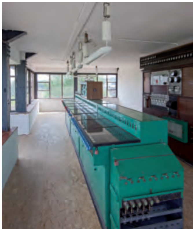
Stavědlo 2 s elektromechanickým technickým vybavením
