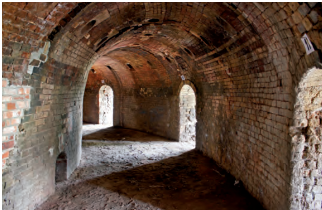
Pohled do kruhové spalovací komory
