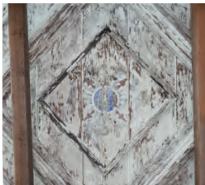
Stropní kazeta se zbytky výmalby
