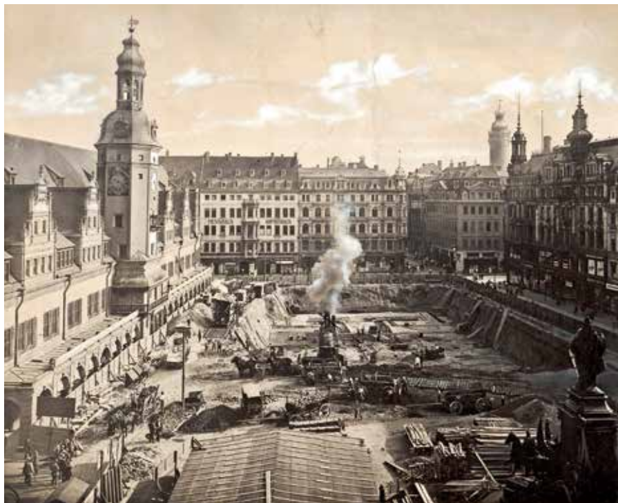
Bauarbeiten zur Untergrund-Messehalle am Markt, August 1924, Fotograf: Paul Faulstich, Leipzig (Sächsisches Staatsarchiv, Staatsarchiv Leipzig, 20202 Leipziger Messeamt (I), Nr. F 3308)
