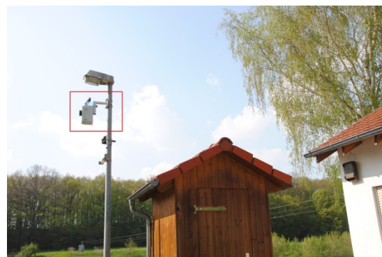
Abb. 57: Pegelstation Golzern mit Messaufbau
