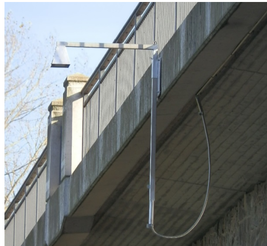
Abb. 23: Radarsensor an der Straßenbrücke Pegel Kössern (Vereinigte Mulde)
