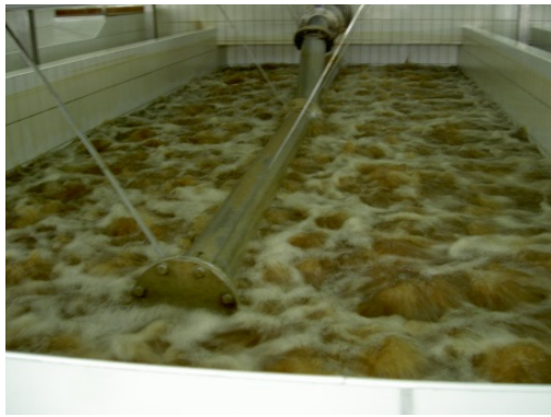
Abb. 8: Eingangsfiler im Wasserwerk während der Rückspülung.
