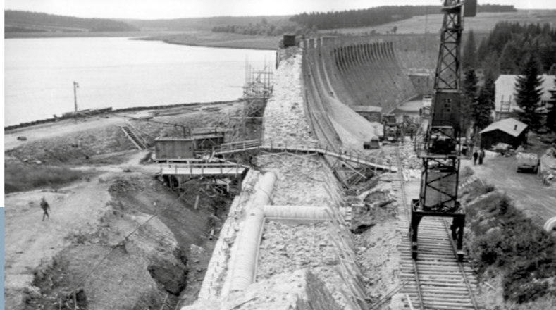
beräumte Bruchstelle im Juli 1949
