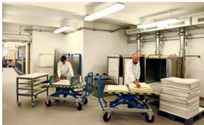
Strömungstrocknungsanlage im Archivzentrum Hubertusburg (Foto Regine Bartholdt)
