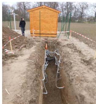
Abb. 6: Stationsgebäude und offener Schurf mit Sonden auf der neu errichteten BDF II - Fläche Köllitsch
