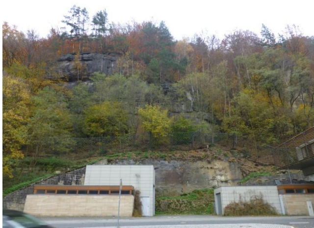
Abb. 1: Felswand und Sicherungsmaßnahmen bei der Grenzübergangsstelle Schmilka (Vernagelung oben, Steinschlagschutznetz unten)
