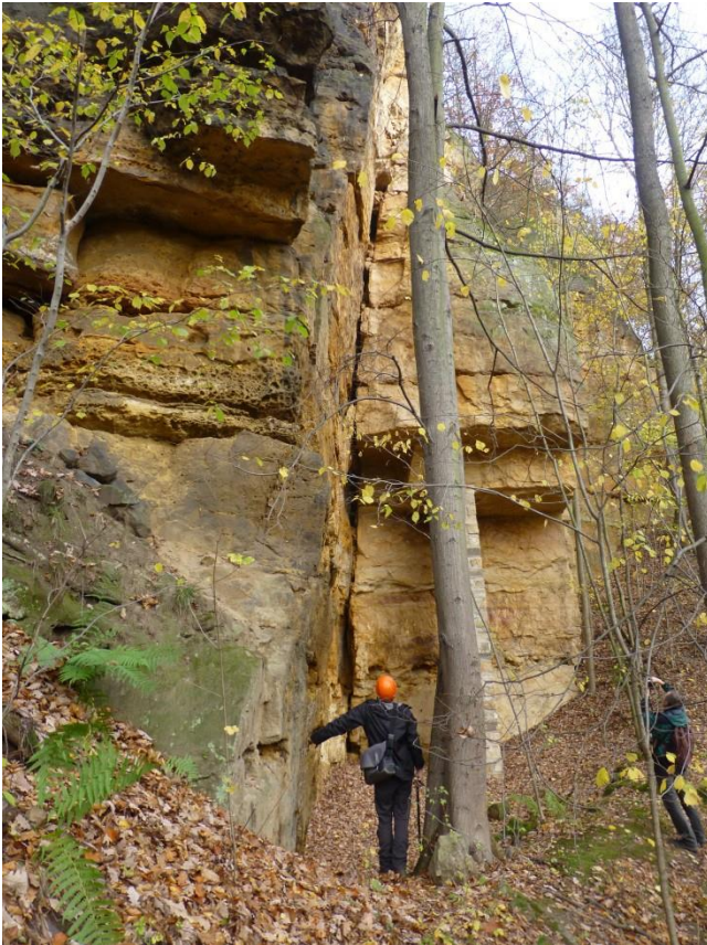
Abb. 1: Vom Felsverband gelöster Felsturm. Sicherung durch einen schlanken gemauerten Pfeiler.
