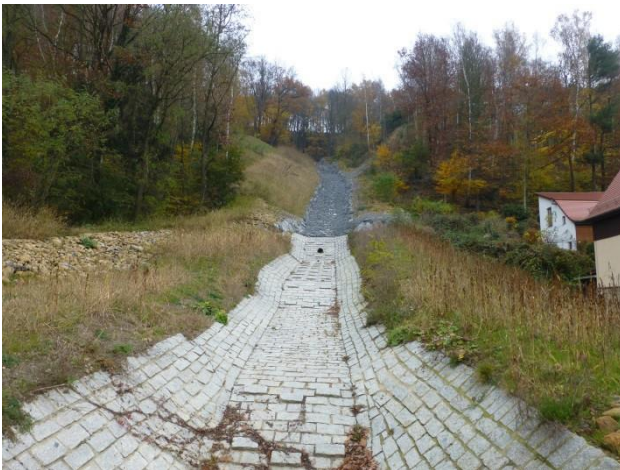
Abb. 2: Nach einem Murgangereignis verbaute Abflussrinne
