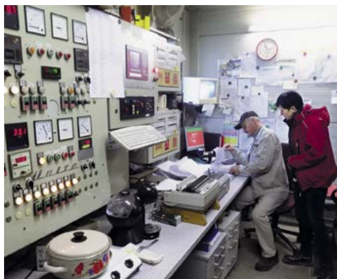
Abbildung 26: Betriebskontrolle im Mischfutterwerk
