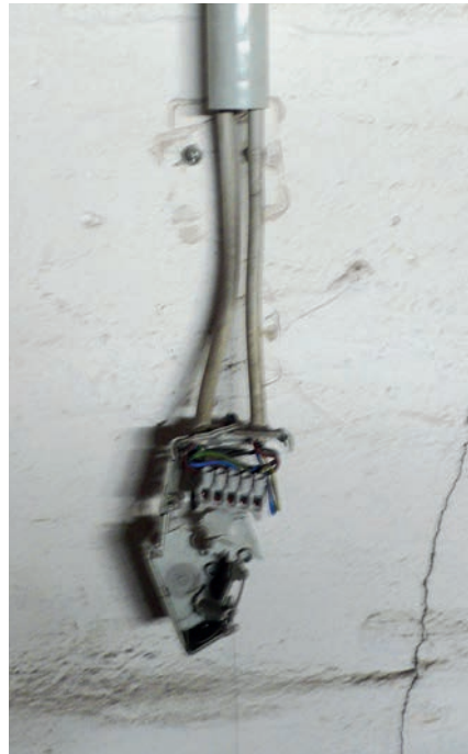
Defekter Verteiler – Stromschlaggefahr
