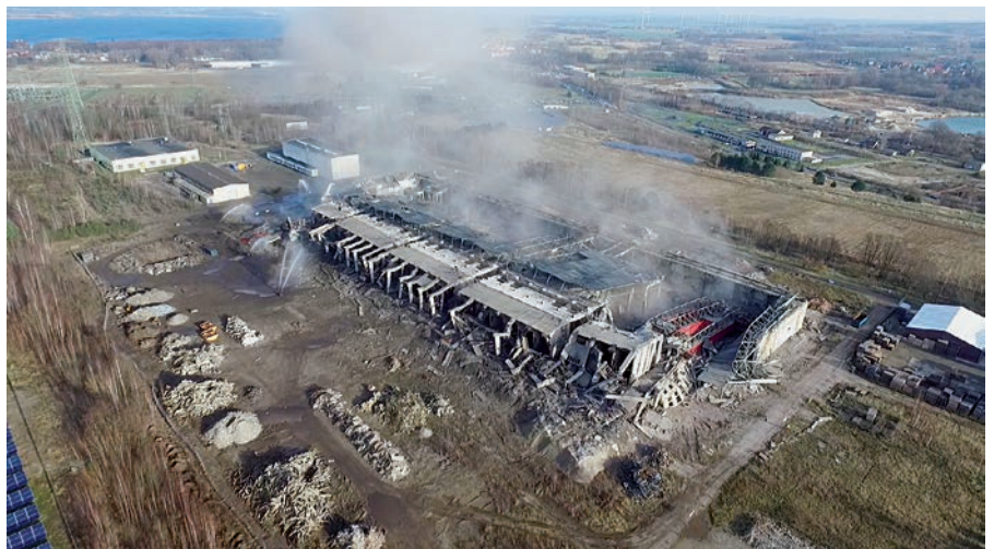
Es ist vollbracht – die Staubwolke verzieht sich langsam und lässt den Blick auf die Überreste frei
