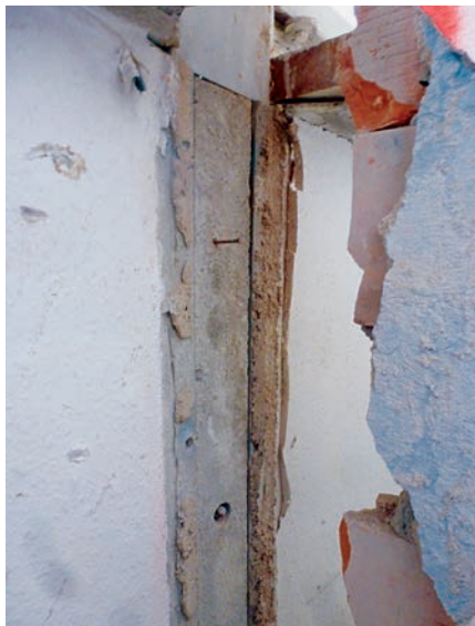
Aufbruch von Mauerwerk zwischen Sokalitplatte und Trennwand
