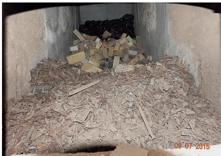
Eingestürztes Bogengewölbe im Feuerraum
