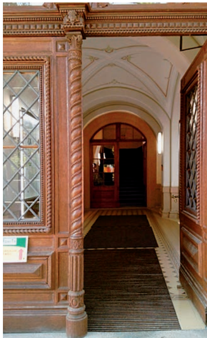
Rechtswidriger Notausgang (erster Fluchtweg) einer Fachschule in einem denkmalgeschützten Gebäude
