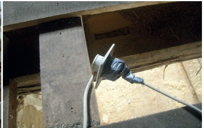
Gefährliche elektrische Betriebsmittel
