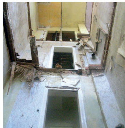
Massiver Eingriff in die Statik des Gebäudes
