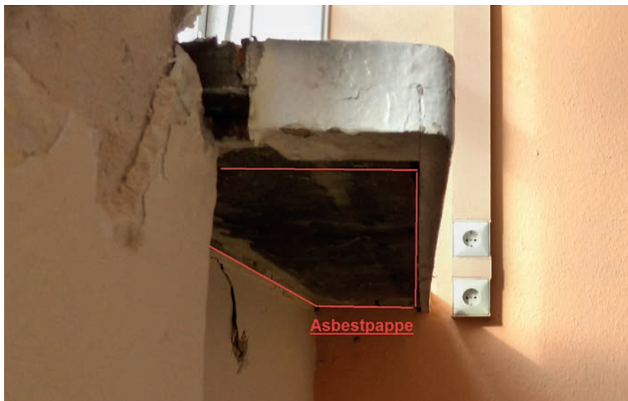
Fensterbank mit Asbestpappe
