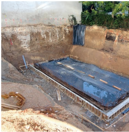
Unzureichende Herstellung der Bermen
