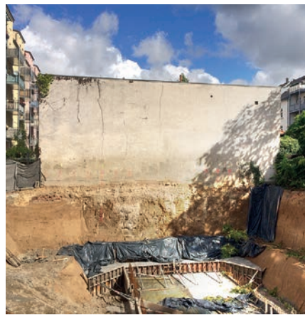
Rissbildung der Nachbarbebauung
