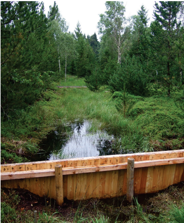
Abb. 17: Anstau in der Hühnerheide bei Rübenau: Holzspundwand vor Torfüberdeckung. Foto: K. Keßler 2007
