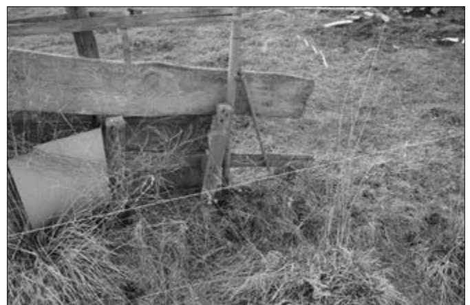
Unsachgemäßer Zaun mit verschiedenen Flickmaterialien
