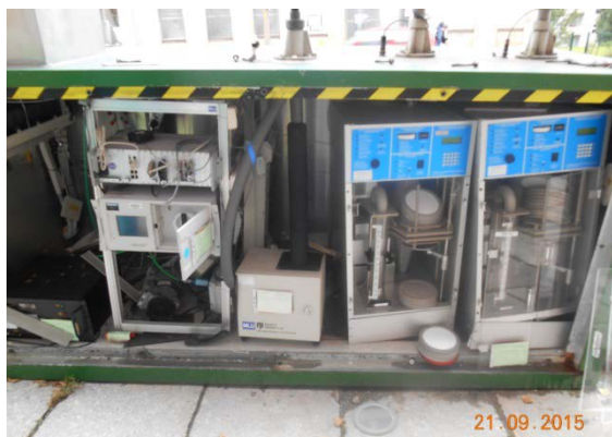
Abb. 6: geöffnete Messstation nach dem Verkehrsunfall
