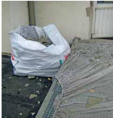
Ungeeignete Auffangmöglichkeit für herabfallende Asbestzementteile bei Arbeiten an Außenwänden
