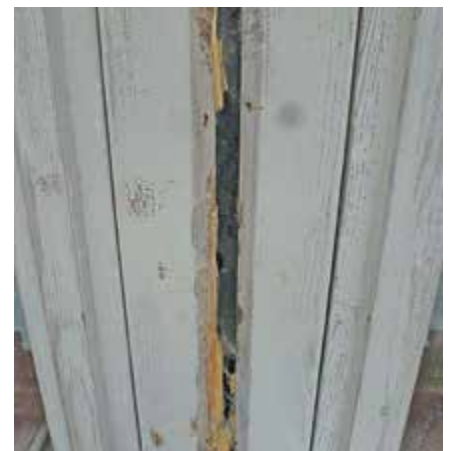
Morinolfugenkitt im Fensterrahmen
