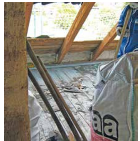
Unzulässige Demontagetechnologie einer Asbestzementschieferdeckung
