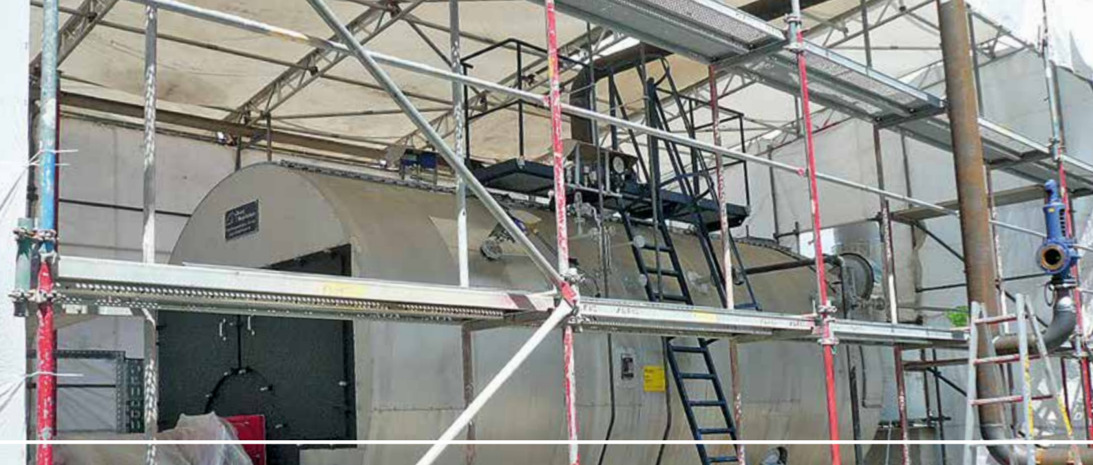
Aufstellungsbereich der Mietdampfkesselanlage vor Beratung und Erneuerung
