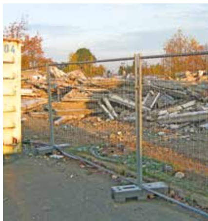
Hausabbruch ohne vorherige Entfernung von asbesthaltigen Bauteilen
