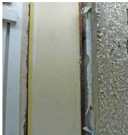
Asbestzementstreifen neben dem Fenster
