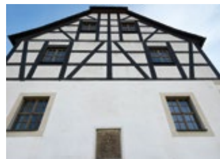
Das alte Fachwerk konnte nicht gerettet, das Obergeschoss musste komplett erneuert werden.
