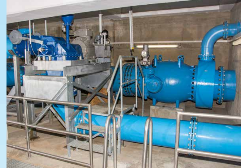
Wasserkraftanlage und Ringkolbenventil
