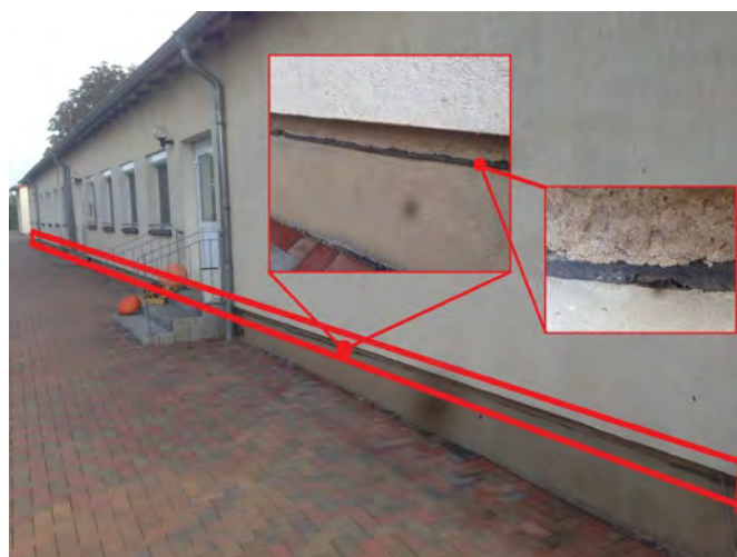
Abbildung 1: Kindergarten, dessen Sockel mit Teer abgedichtet wurde
