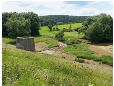
Damm eines Regen-Rückhaltebeckens in Freital nach einem Einstau 2014, der Wiesenknopf-Standort auf der Dammkrone ist davon nicht betroffen
