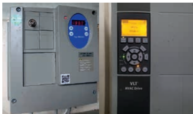
Abbildung 19: Frequenzumrichter von Abluftventilatoren, rechts im Bild ein Gerät mit Stromverbrauchsanzeige
