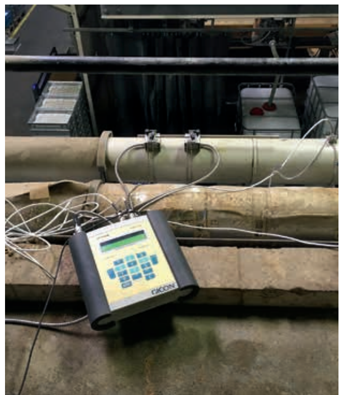
Abbildung 11: Messtechnikeinsatz bei der Energieberatung (Ultraschall-Durchfluss-/Wärmemengenmessgerät)
