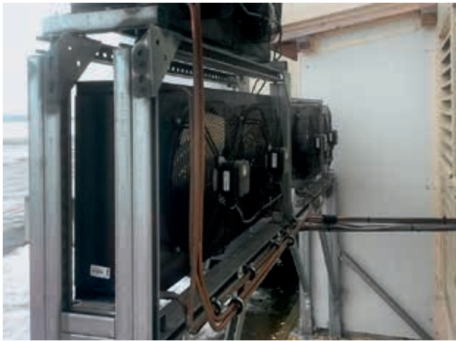
Abbildung 14: Außen aufgestellte Verflüssiger der Kältemaschinen eines Milchtanks
