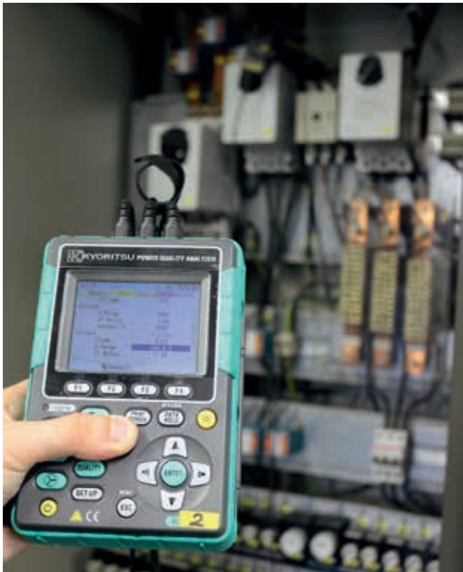
Abbildung 7: Anschluss mobiler Strommesszangen an einen Verbraucher
