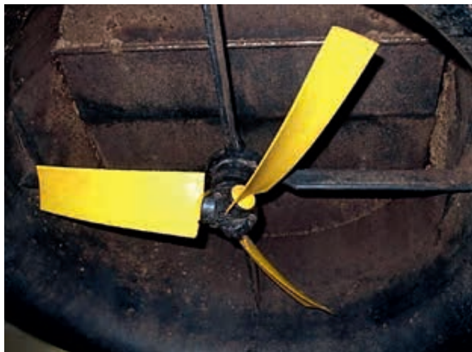
Abbildung 20: Messventilator mit Drosselklappe im Bestand
