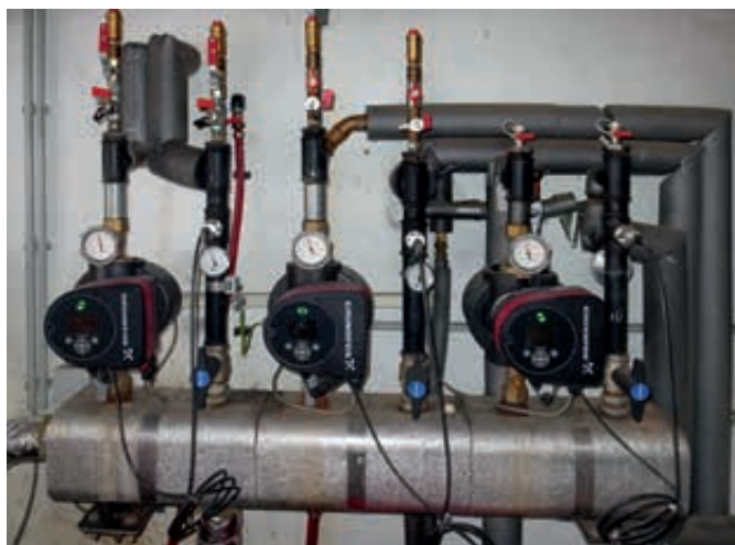
Abbildung 21: Hocheffiziente Nassläuferpumpen einer Heizungsverteilung in einem Schweinehaltungsbetrieb
