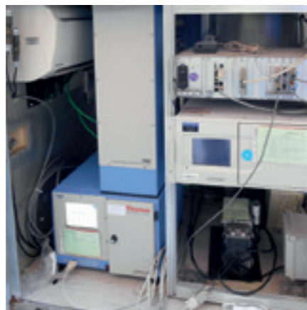
Abb. 4: Einbau eines automatischen Staubmessgerätes vom Typ TEOM-FDMS in der Station Chemnitz-Leipziger Straße
