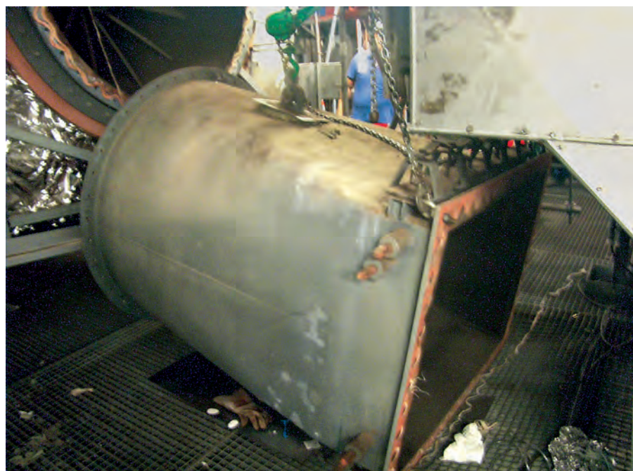
Unfallort mit abgestürztem Bauteil des Rauchgaskanales
