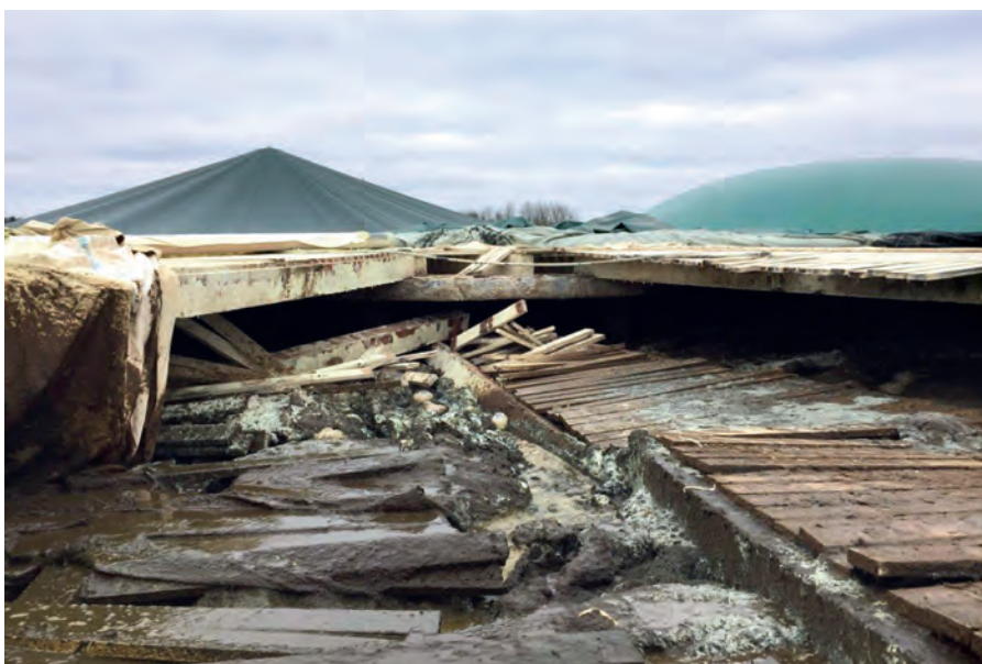
Havarierte Holzbalkendecke der Biogasanlage
