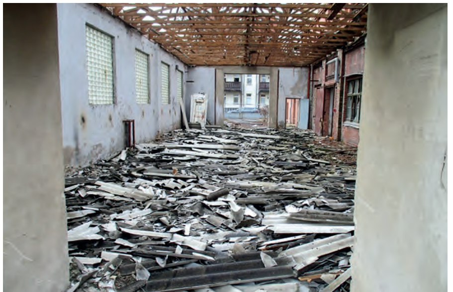
Unsachgemäßer Abbruch von Asbest
