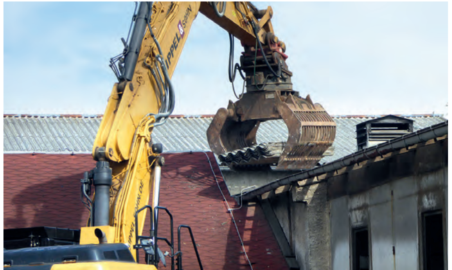
Unsachgemäßer Umgang mit Asbest
