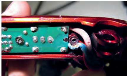
Abbildung 7: Überbeanspruchung der Isolation infolge ungeeigneter Kabelverlegung
