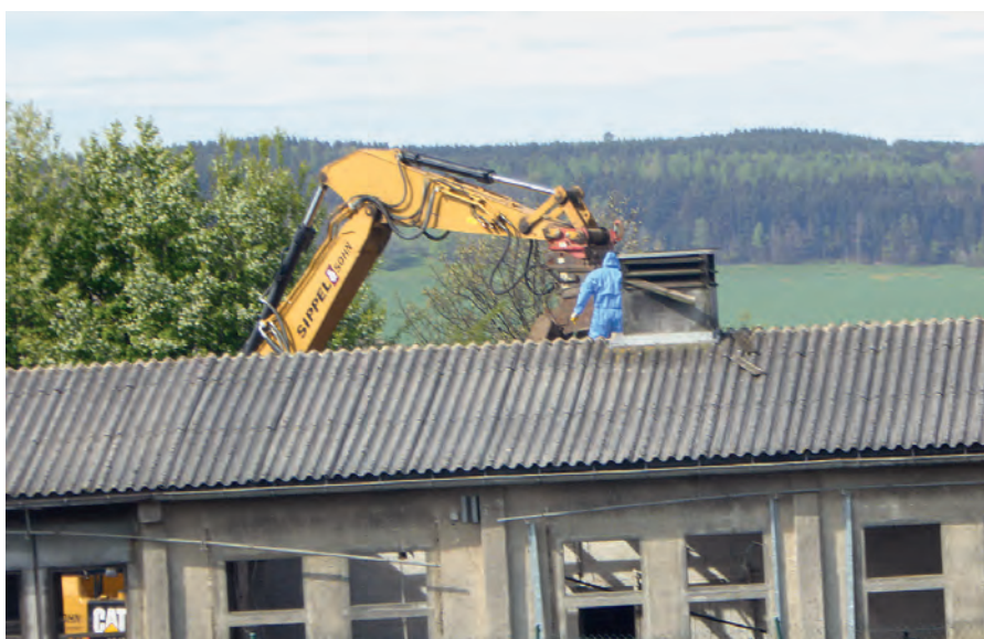
Demontage von Asbestzement ohne Absturzsicherung
