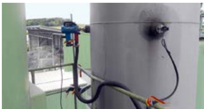
Emissionsmessungen an einem Schornstein
