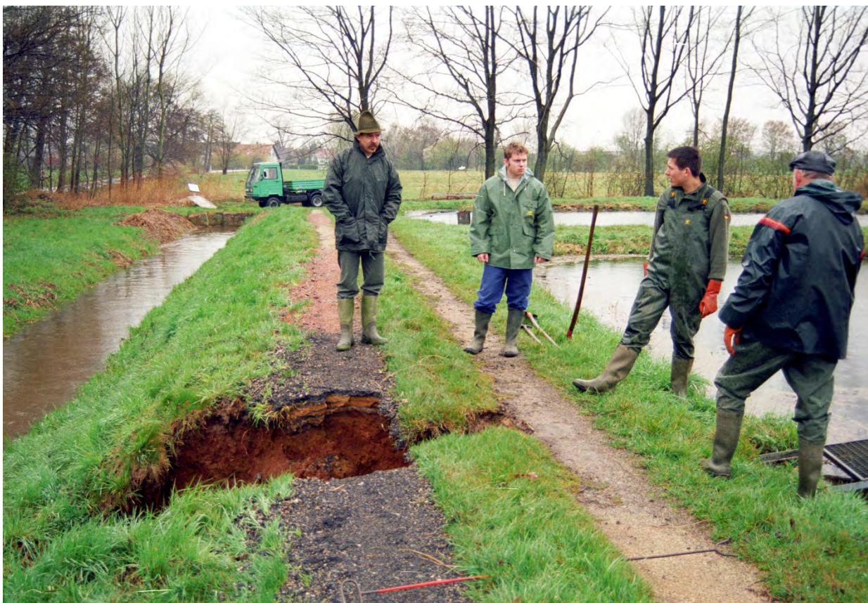
Auch rasche Notinstandsetzungen, wie hier nach dem Dammbbruch in der VTA, sind notwendig
